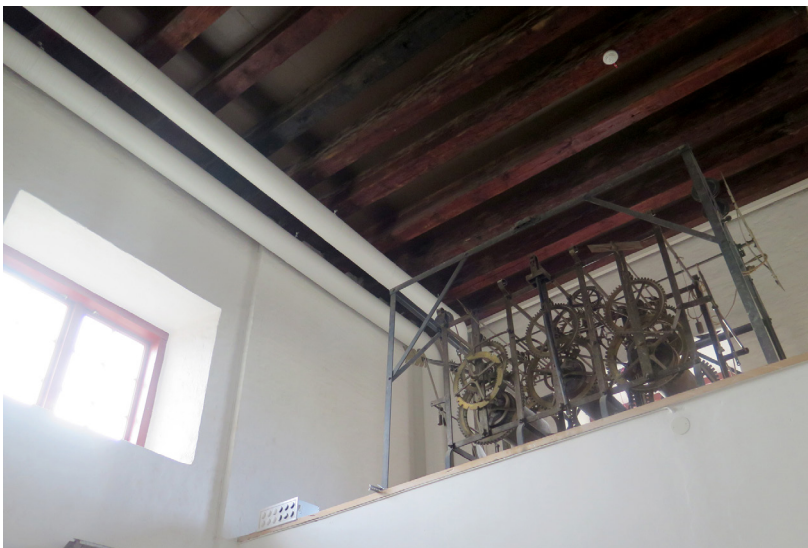
Bilden nedan visar det södra tornrummet med nya ventilationstrummor i taket.
