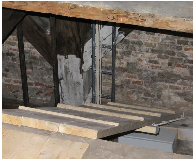
Bilden visar vinden över kyrkorummet. Brandskyddsfärg har applicerats på delar av tre takstolar på vinden.
