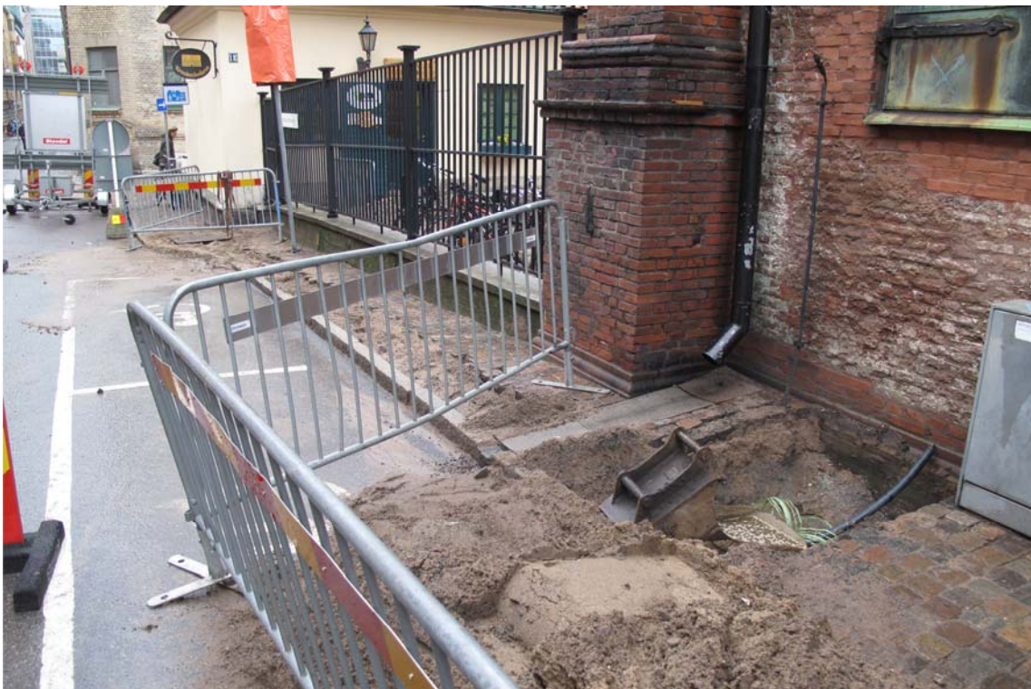
Bilaga 2. Översikt över schaktets utbredning. Övre bild mot SV, nedre bild mot SO.
