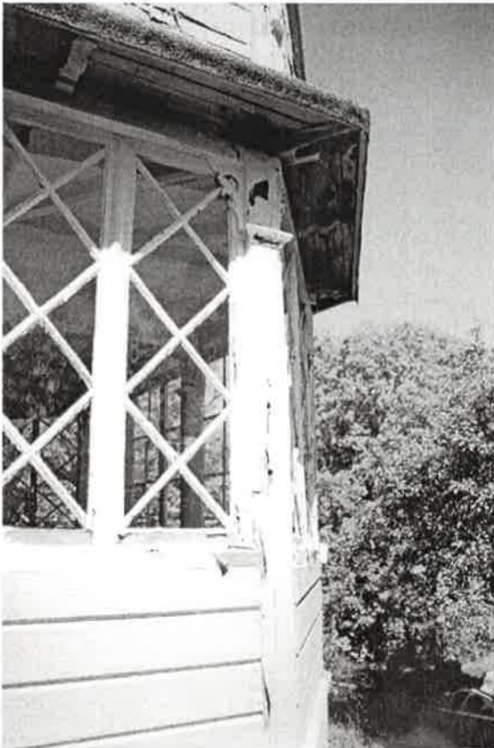
Flagande färg och äldre rötskada i utskjutande panel, ny takpapp hindrar förvärrad skada.
