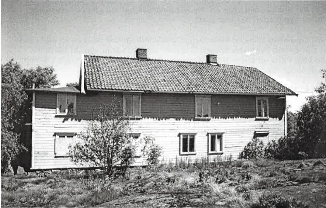
Vindskivan har lossnat i takets norra (vänstra) del och vatten kan tränga in
