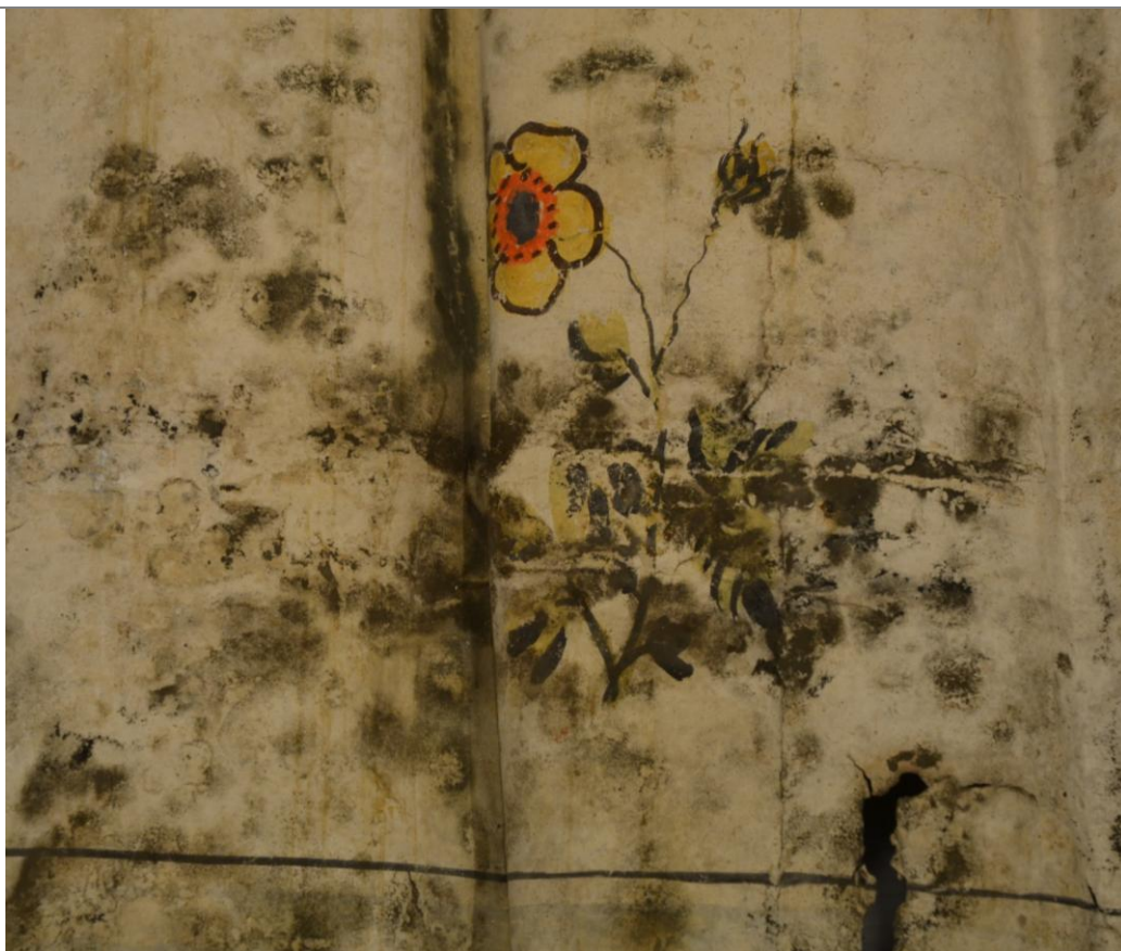
Detalj av fuktskadad handmålade tapet med kraftig mögelpåväxt
