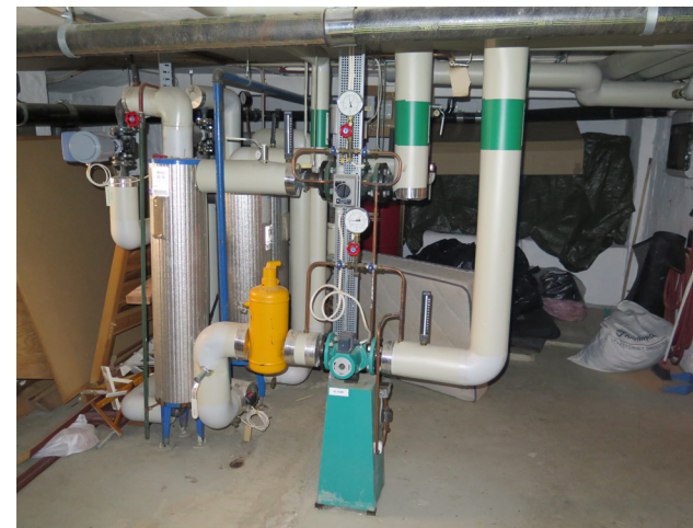
Rum i källare med fjärrvärmeutrustning.
