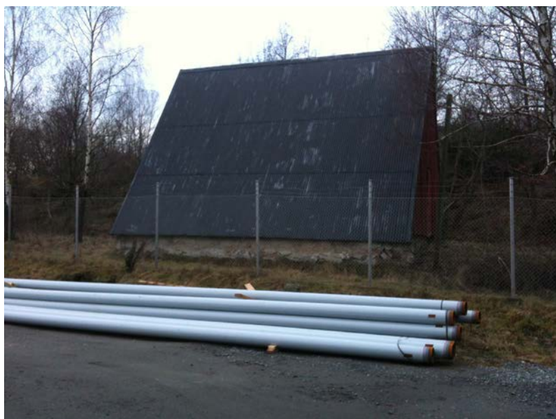
Figur 26. Översikt över krutkapelllets östra sida. Takbeklädnad består idag av korrigerad svartmålad plåt.
