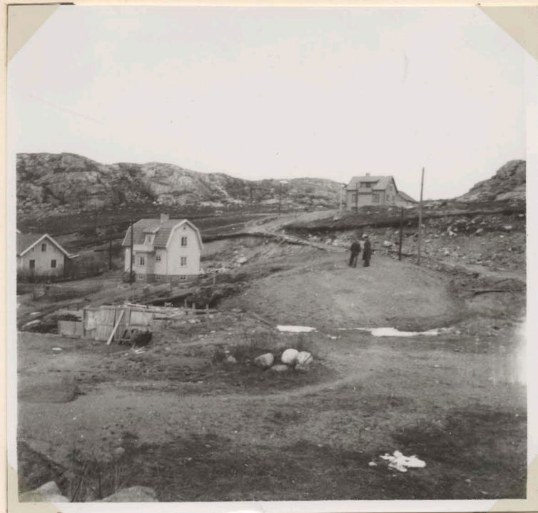
Foto 6. Efter plåt n:r a 1235. B3495 Gravhög vid Fjällbacka. Under pågående restaurering. T.v. gjutning av en stödvall av betong mot tennisbanan. Från P.
