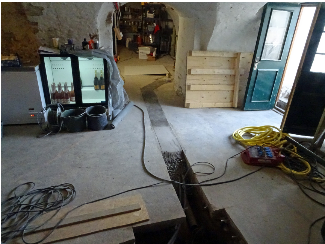
Figur 6. Översikt över norrgående rörschakt, här delvis igenfyllt, i rådhusets källare. Foto mot öst-nordöst.
