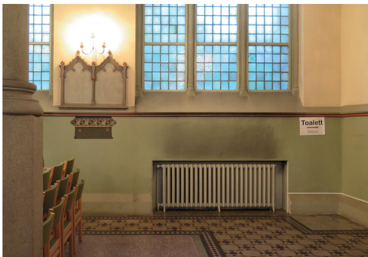
Kyrkans väggar var kraftigt smutsade.
