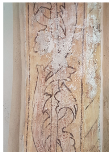
Det förekom saltutfällningar på kyrkans murverk.
