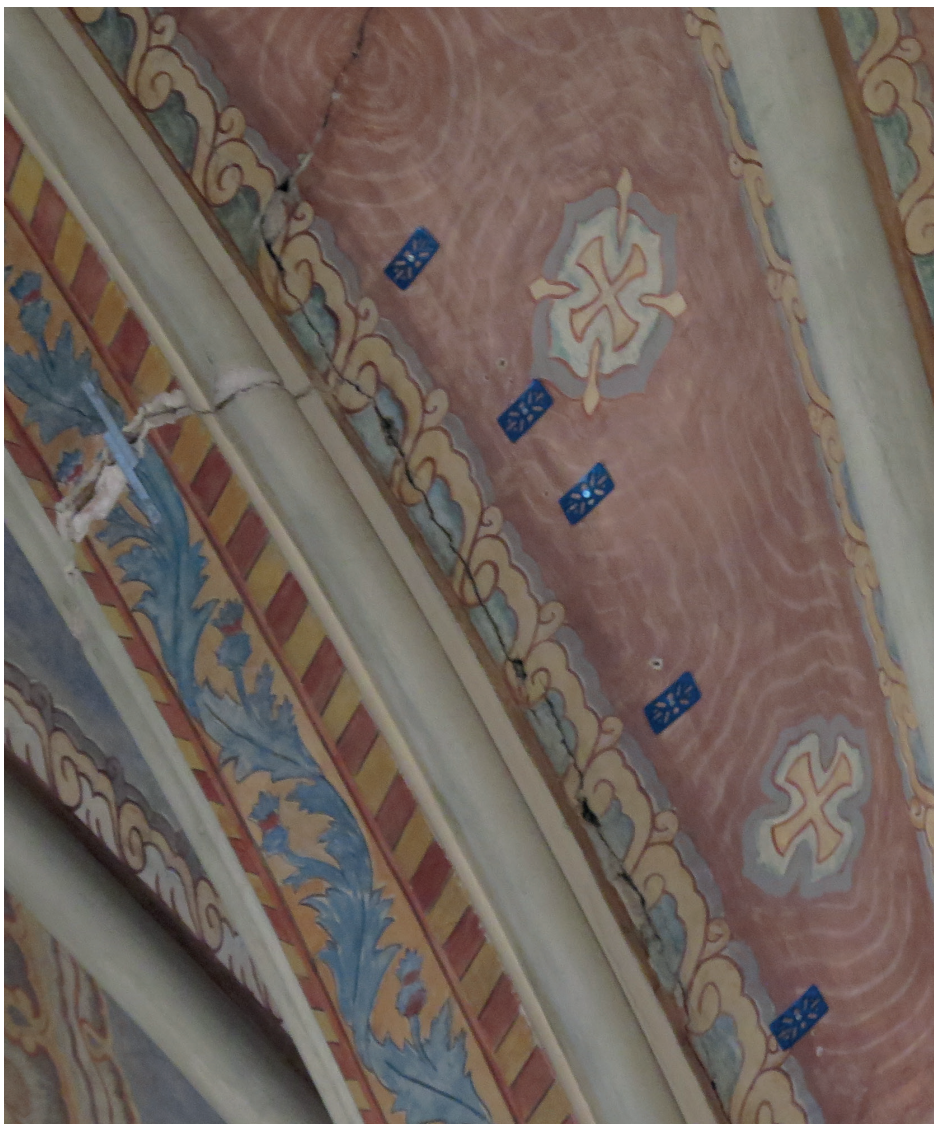
Exempel på gamla skador i putsen.
