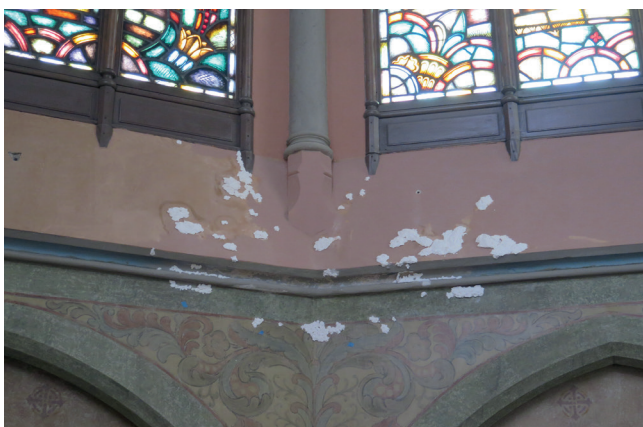
Det förekom saltutfällningar och färgbortfall på väggarna. Här ser vi koret.
