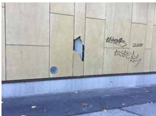
Skada i fasaden samt klotter.
