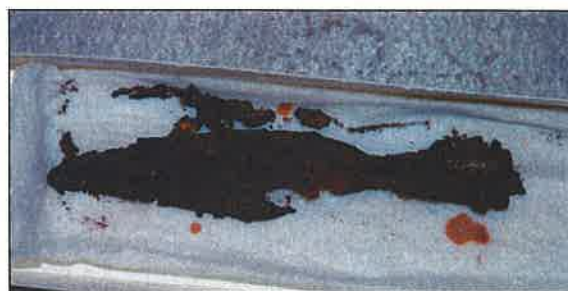
3) Mycket aktiv korrosion.
