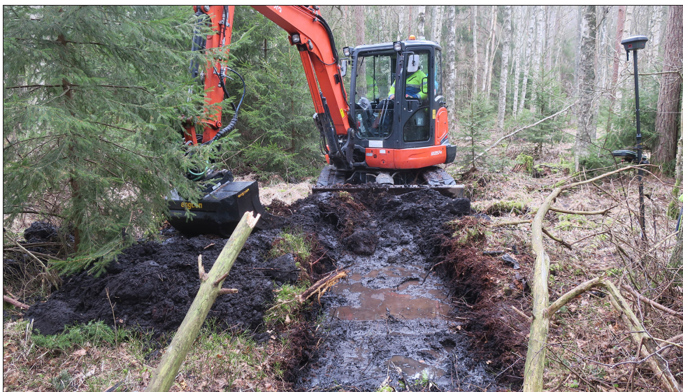
Figur 18. Grävning av S4 med blocken till vänster i bild. Den blöta marken försvårade arbetet. Foto mot öst.
