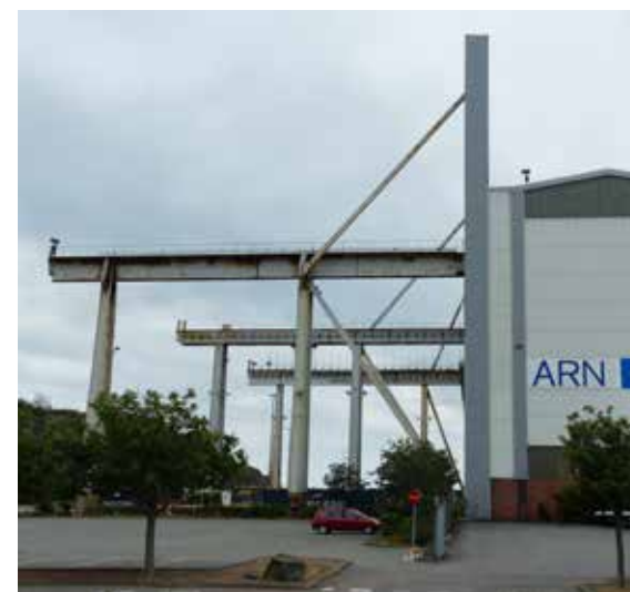
Traversbanorna sticker ut vid östra gaveln, men fortsätter som ett enormt fackverk genom hela byggnaden.
