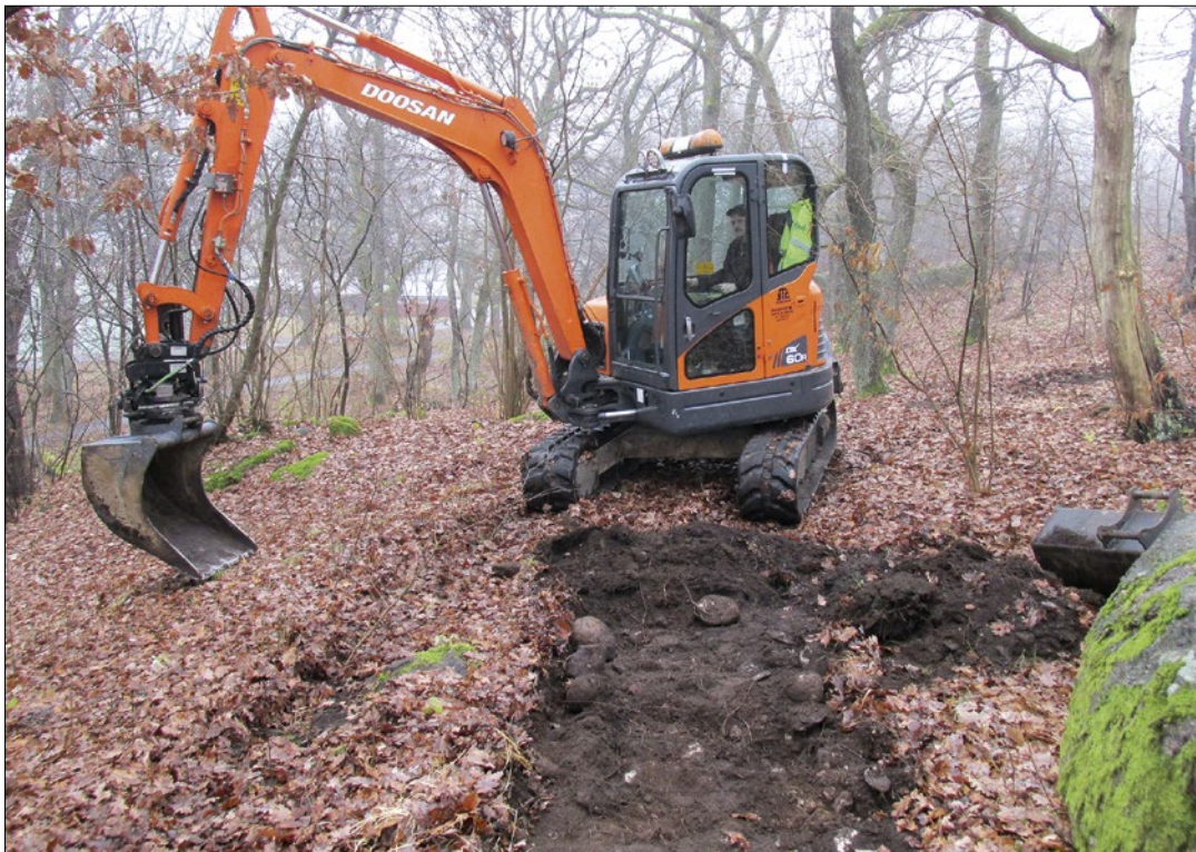
Figur 9. Vår grävmaskinist Tobias Bergqvist tar här fram ett av de schakt som upptogs inom Göteborg 493. Foto: Jörgen Streiffert.
